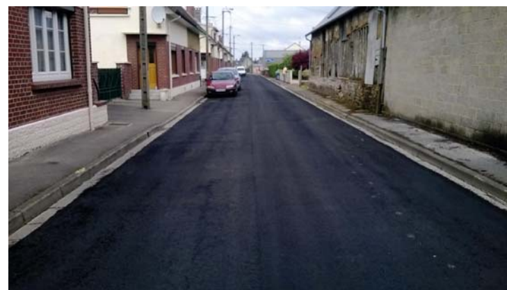
Refection de chaussée à Beaucamps-le-Vieux
